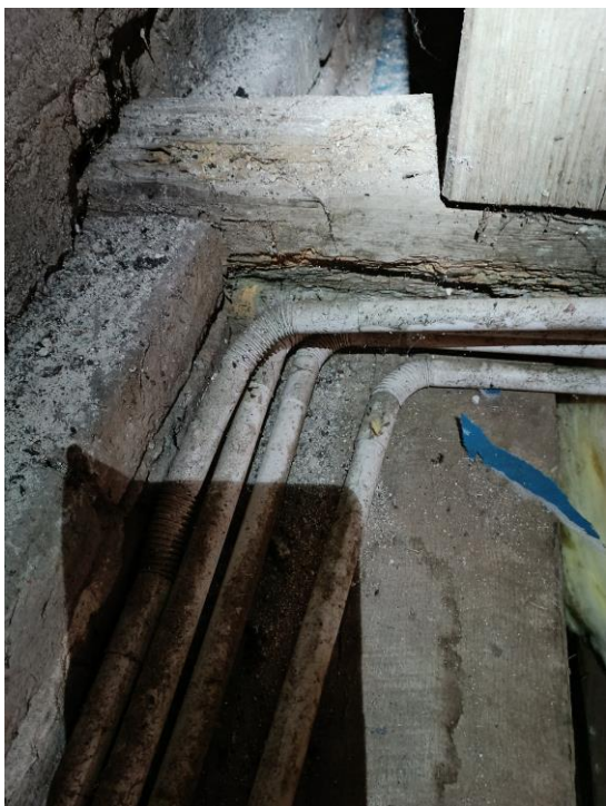
Fot. 2 Widoczna korozja biologiczna belki podwalinowej na styku ze ścianą nad prezbiterium ( oś 19B – 19E)
